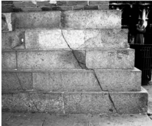
Şekil 22: San Marco Çan Kulesi'ndeki basamaklarda oluşan çatlaklar (Macchi, Macchi, Jamiolkowski, & Pastore , 2013)
